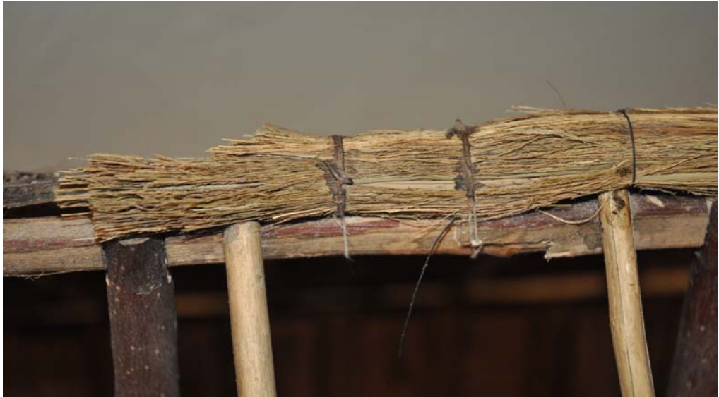
Afb. 15.19. Rietbundels werden vermoedelijk aangebracht tussen de nokbalk en de nokvorsten om de ruimte tussen de balk en de plaggen op te vullen. De plaggen bleven beter liggen en liepen in een scherpere hoek naar beneden zodat het vocht beter afgevoerd kon worden. Een mogelijke bijkomstigheid was dat het vocht uit de plaggen niet direct in de nokbalk zou komen. Het rotten van het hout werd hiermee langer uitgesteld.
